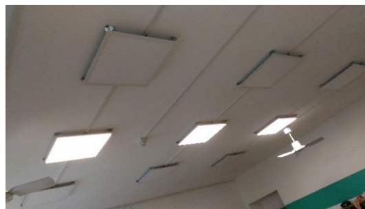
Figura 4.11 - Particolare dei corpi illuminanti ubicati nelle aule
