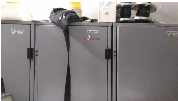
Figura 4.10 - Particolare delle caldaie
